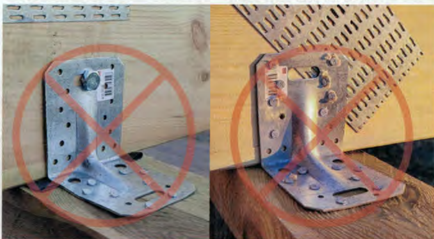
Zdj. 7. Niepoprawny montaż kątowników ACRL do murłaty – błędne obrócenie względem elementów i niepełne gwoździowanie. Porównaj ze zdjęciem 6C i 6A.
