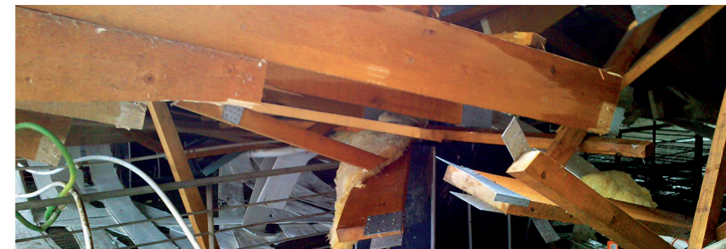
Fot. 6. Zbyt małe łączniki i za mała ilość gwoździ
