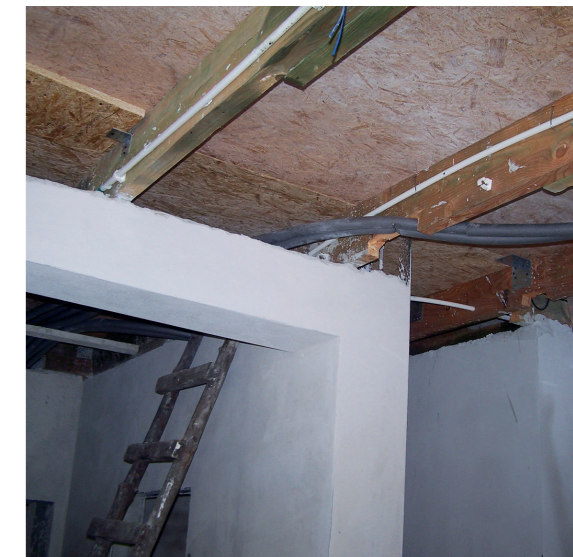
Fot. 5. Niedopuszczalne podcięcie konstrukcji
