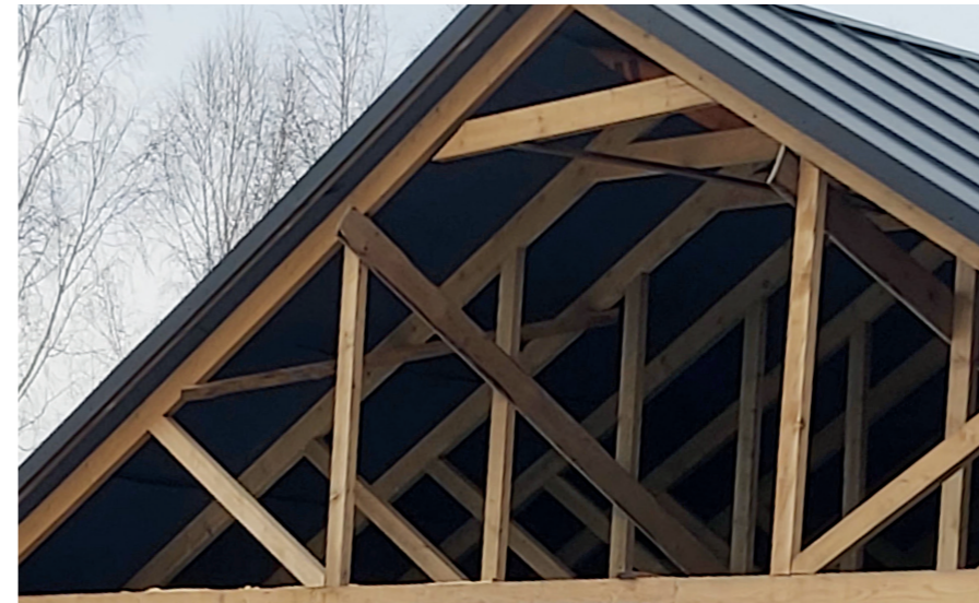
Fot. 3. Brak łączników w więźarze kratowym
